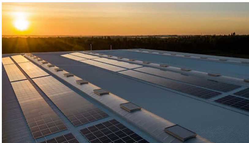
Récupération de chaleur
